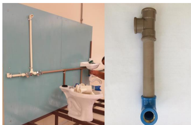
Figura 4 – À esquerda montagem da instalação da tubulação de água fria e água quente. À direita sub-ramal joelho rosca bucha de latão.
