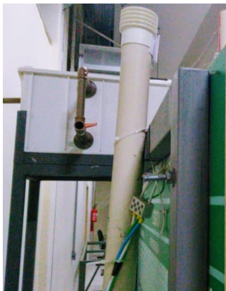
Figura 16 – Tubo ventilador e terminal de ventilação.
