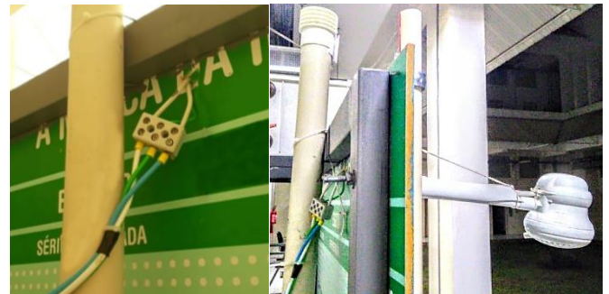
Figura 17 – À esquerda condutores utilizados na instalação elétrica do chuveiro da unidade educativa. À direita instalação elétrica e chuveiro.
