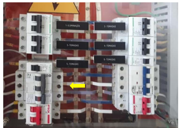
Figura 18 – Disjuntor termomagnético alocado no quadro de distribuição.
