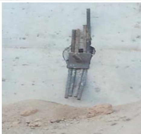
Figura 3 – Colapso estrutural de cortina atirantada (Porto, 2017).
