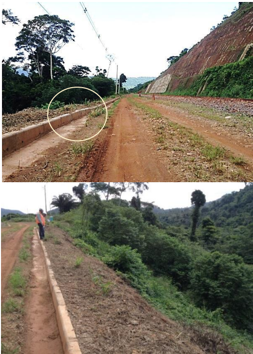
Figura 4 – Plataforma com abatimento de formação de superfície de ruptura em foto à esquerda e talude do aterro excessivamente íngreme à direita. Pará, Brasil. 2020.
