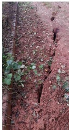
Figura 6 – Trinca na plataforma. Pará, Brasil. 2020.
