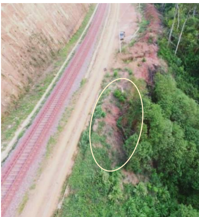
Figura 5 – Ruptura do talude do aterro. Pará, Brasil. 2020.
