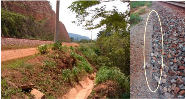
Figura 1 – Vista panorâmica do ativo e trinca entre o talude lateral esquerdo e a plataforma. Pará, Brasil. 2020.
