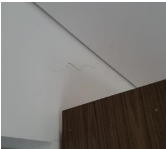
Figura 6 – Fissura que vai descendo do teto, na parede do quarto.
