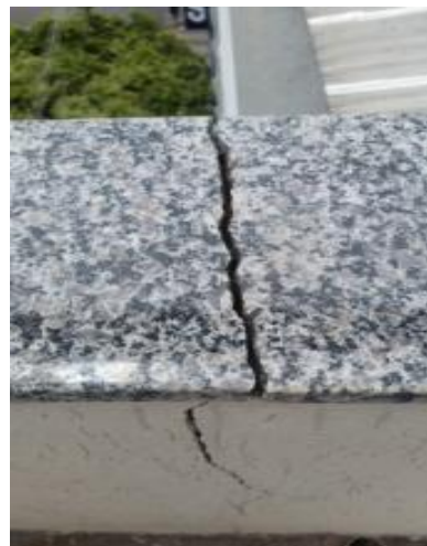
Figura 8 – Trica no guarda corpo do prédio.
