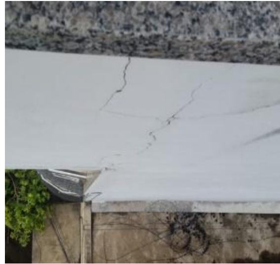
Figura 6 – Fissura externa na cobertura do prédio, acima do apartamento, a patologia está adentrando essa parede de alvenaria.
