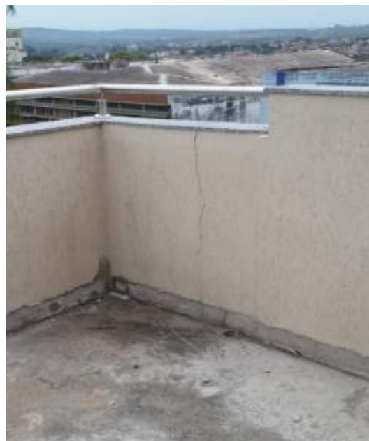
Figura 7 – Fissura interna na cobertura do prédio que adentra a parede, a patologia ocorre no mesmo rumo do apartamento.
