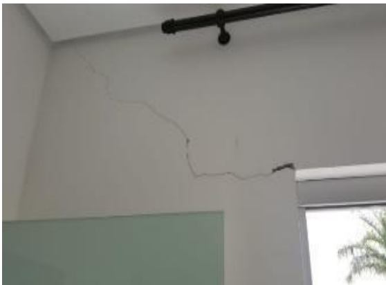
Figura 5 – Fissura em 45 graus situada na mesma região da patologia da varanda, porém é na parede do quarto.
