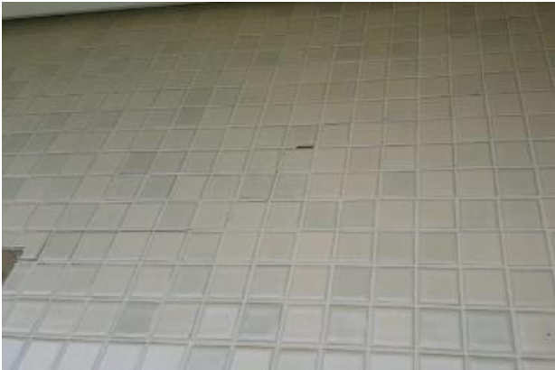
Figura 4 – Fissura em 45 graus situada na parede da varanda do apartamento.
