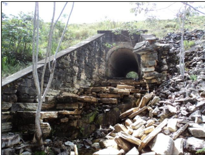
Figura 18 – Boca jusante e escada dissipadora de energia do bueiro ogival próximo ao distrito de Conselheiro Mata.
