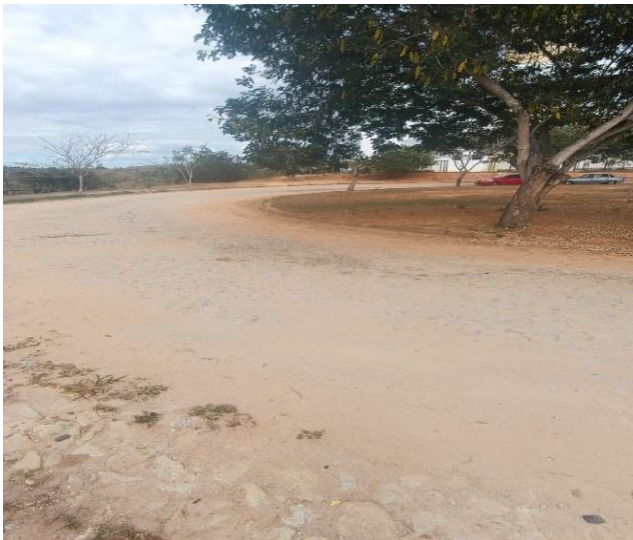
Figura 13 – Insuficiência de boca de lobo.
