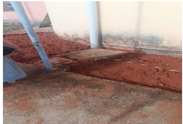
Figura 9 – Local onde estava desconectada a tubulação.
