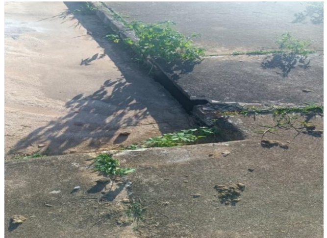
Figura 27 – Acúmulo de areia na boca de lobo.
