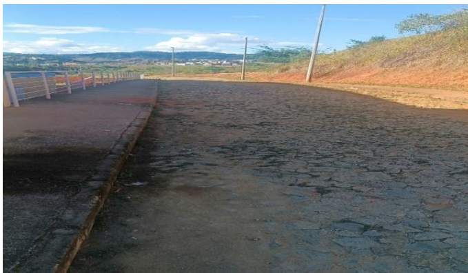
Figura 6 – Ausência de boca de lobo.
