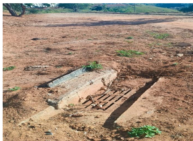
Figura 18 – Obstrução da boca de lobo.
