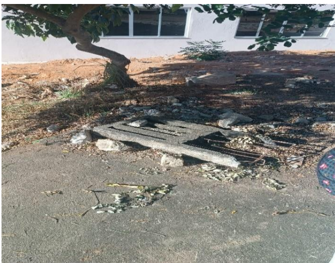
Figura 14 – Boca de lobo quebrada e obstruída.
