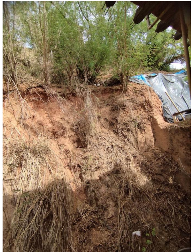
Figura 6 – Talude Exposto a erosão.
