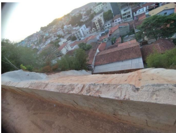
Figura 9 – Ausência de drenagem na Rua Oito.
