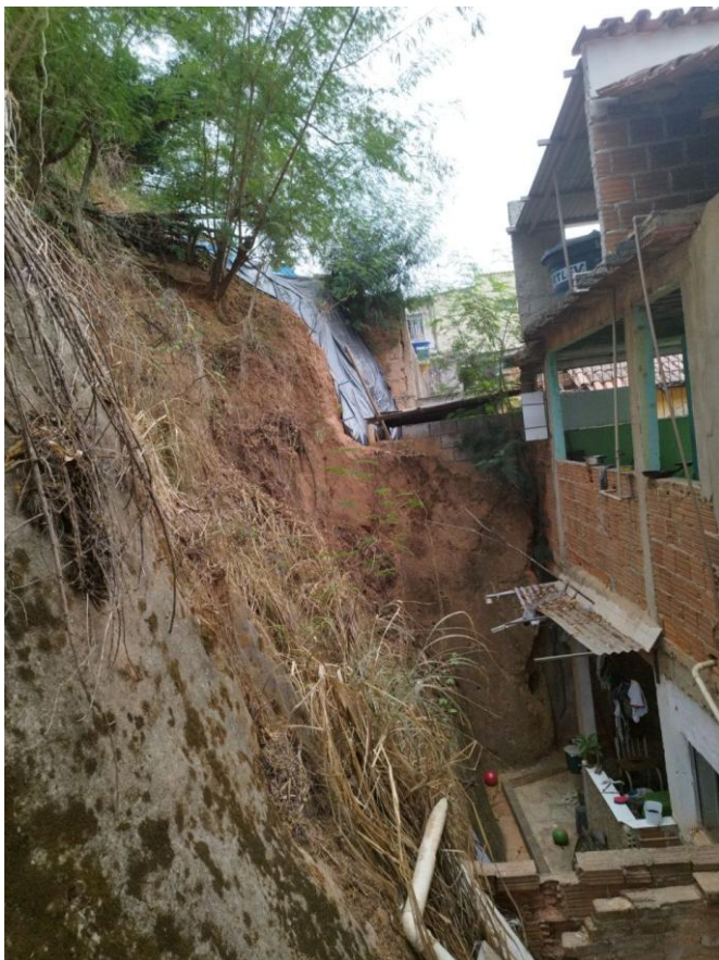
Figura 5 – Talude exposta a erosão vista lateral
