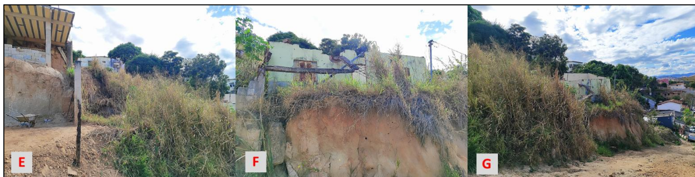
Figura 6 – Os pontos E, F e G apresentam as fissuras no solo e paredes de edificações inclinadas com rachaduras, evidenciando sinais de movimentos de rastejo na área estudada.
