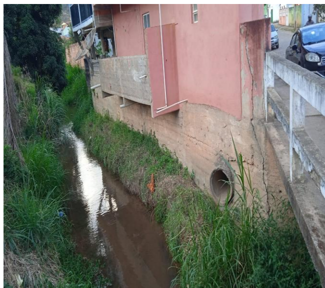
Figura 2 – Ponto B: Rua Teófilo Pereira, nº 98 (prox.), coordenadas 18°13'47.96"S, 42°50'26.58"O.
