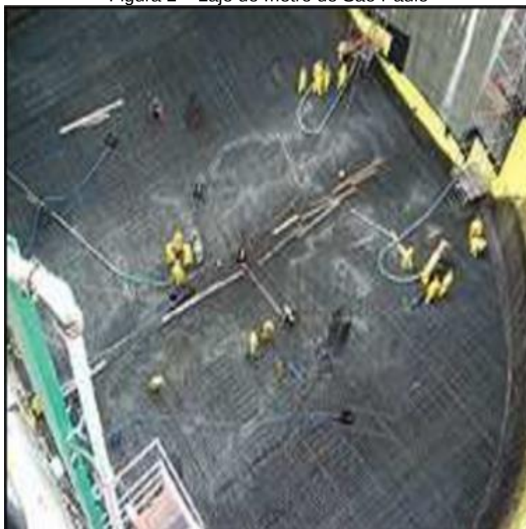
Figura 2 – Laje do metrô de São Paulo
