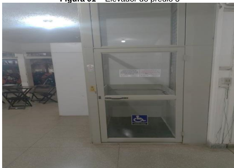
Figura 01 – Elevador do prédio 3
